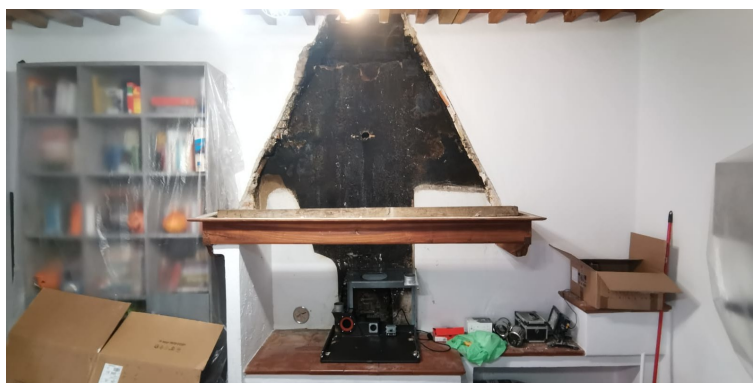
Caminetto Esistente con bocca di grandissime dimensioni (la cappa è già stata demolita)
